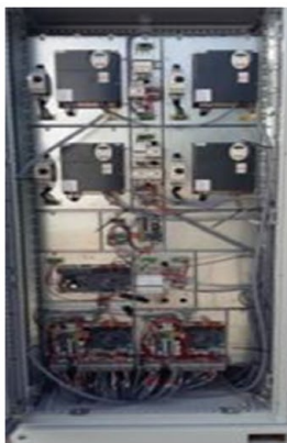
Variadores del ventilador + variadores de la bomba + placas electrónicas
