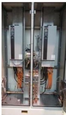
Variadores del compresor + conexión de alimentación principal
